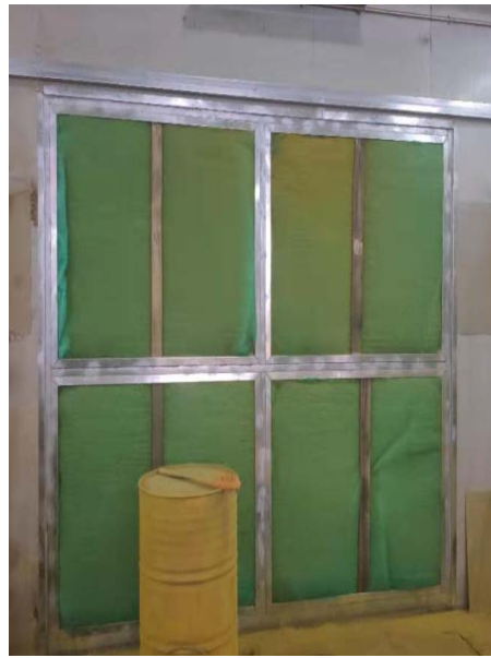
封闭喷漆间风出口1次过滤棉
