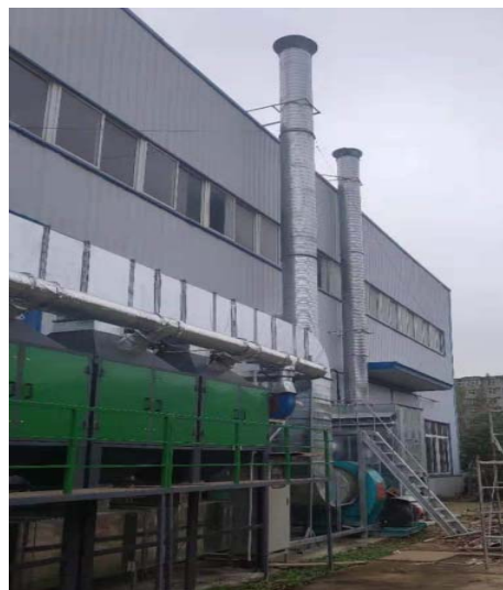
活性炭吸附箱及有机废气排气筒
