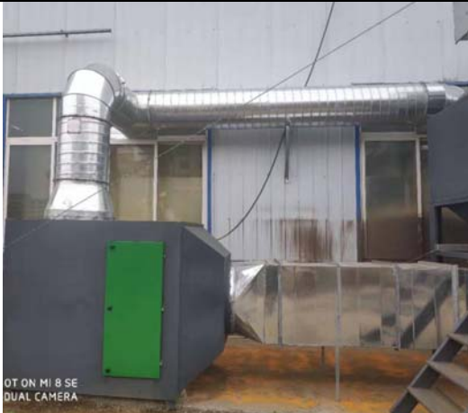
二次过滤棉箱
