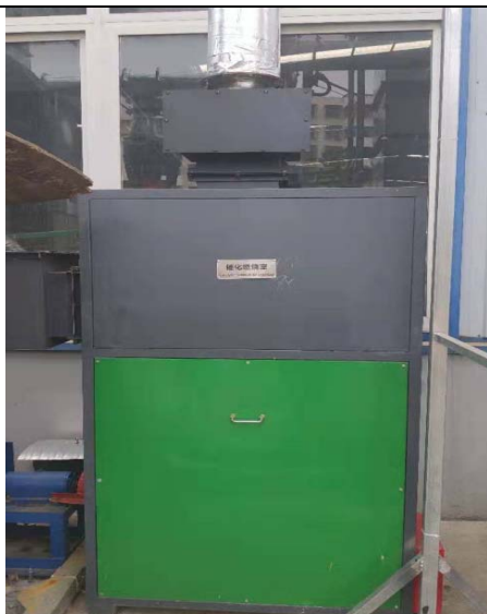
有机废气催化燃烧装置
