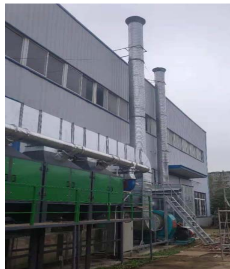
活性炭吸附箱及有机废气排气筒
