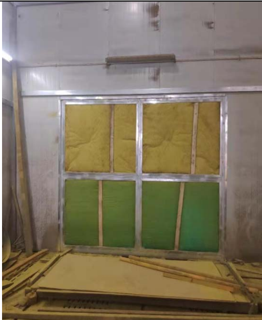
封闭喷漆间风出口1次过滤棉
