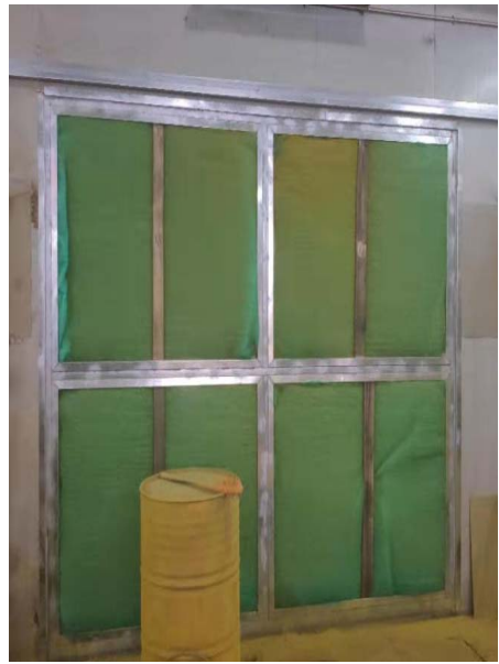
封闭喷漆间风出口1次过滤棉
