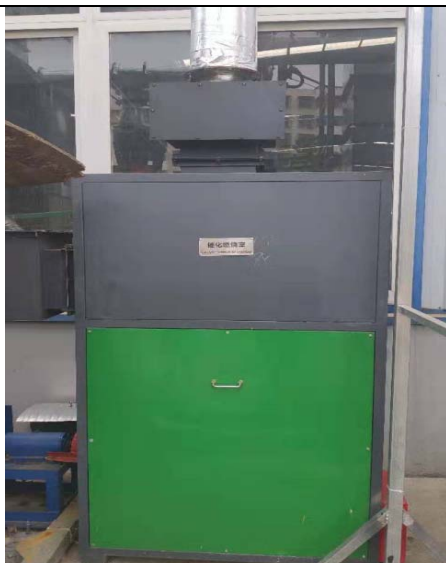
有机废气催化燃烧装置
